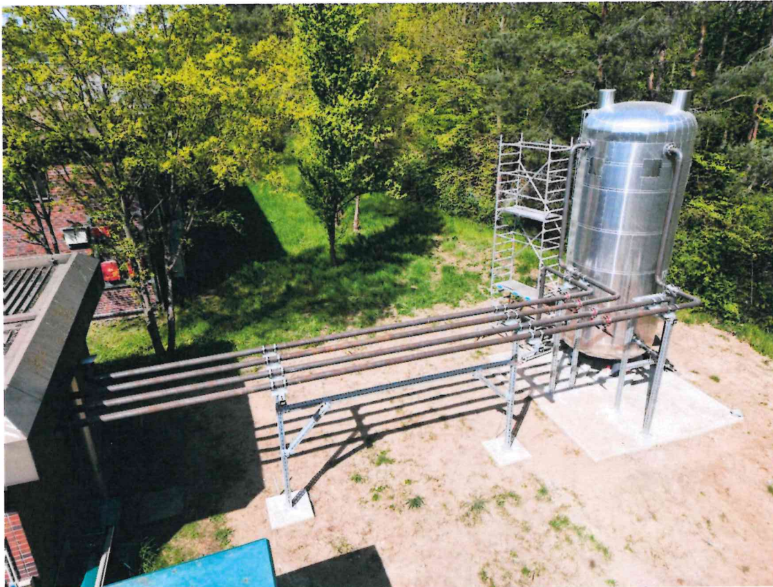
Abbildung 4: Installation eines Pufferspeichers
